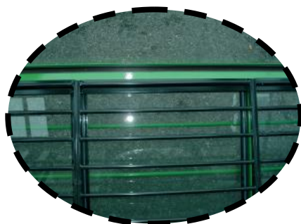
PARRILLA DE PROTECCIÓN INTERNA Y EXTERNA EN EL PISO
